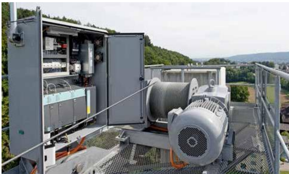
Der Schaltschrank mit der Steuerung und den Umrichtern liegt exponiert auf dem Ausleger des Krans.
