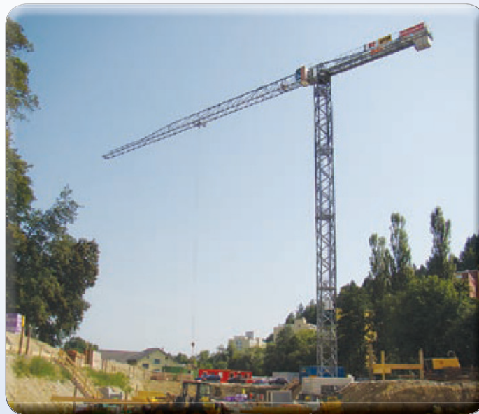
Spitzenloser in Schaffhausen: Der TL 5518/5 ist der erste, der mit der neuen Technik ausgeliefert wurde
