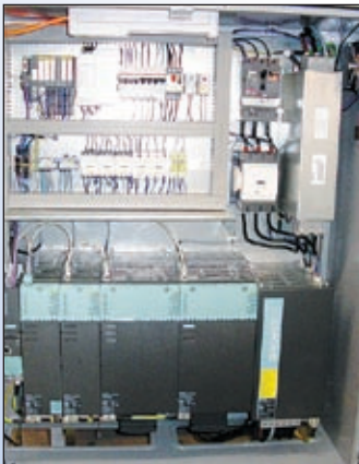
Einblick ins Herzstück der neuen Kransteuerung
